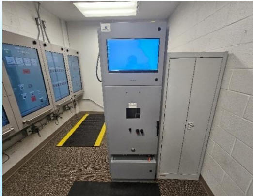
Figure 7. HV ERS 2 FMS HV Breaker
